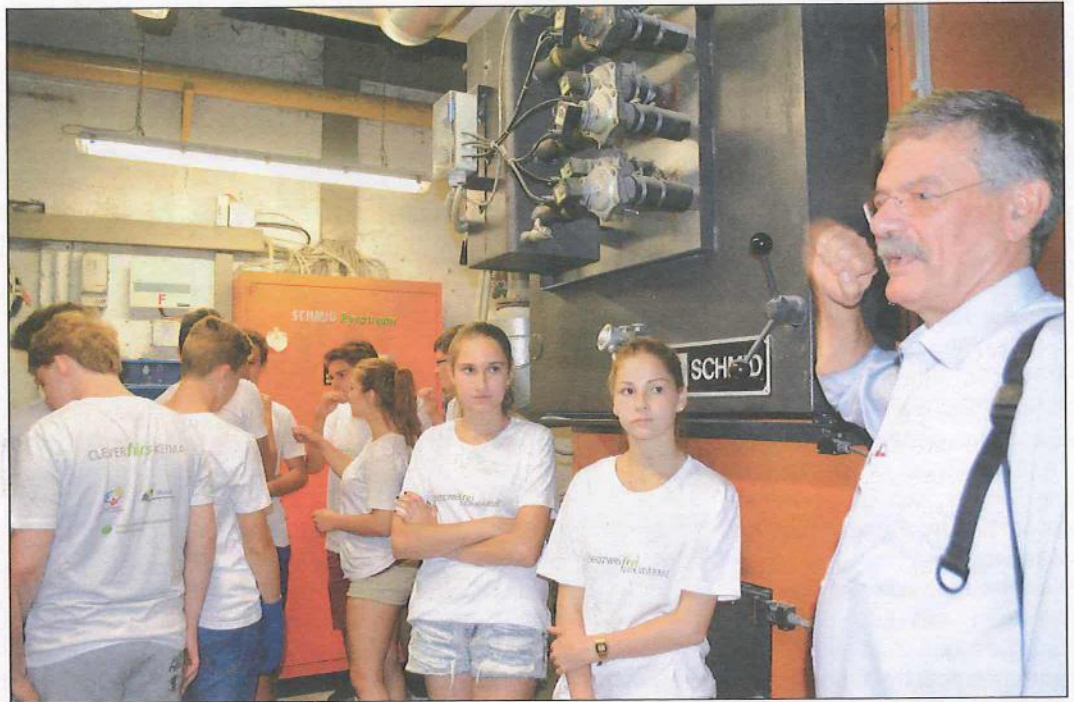
Das Herz der Heizanlage ist die Hackschnitzelanlage, die in der Heizzentrale neben dem Bürgerhaus untergebracht ist. Die Schüler ließen sich von Energieingenieur Uwe Gähns (rechts) ihre Funktion erklären. (Foto oben).
