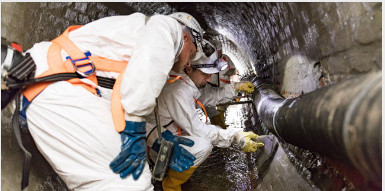
Bild 1: Die Sanierung der Kanäle steht bei den Leipzigiern im Fokus der Investitionstätigkeiten. Zum Controlling des Kanalsanierungsprogramms helfen etwa die Werte „Sanierte Kanallänge im km“ und „Sanierungsrate in %“ weiter. Sie werden im Kanalsanierungsbericht, einem Teilbericht des Kennzahlensystems, erfasst
