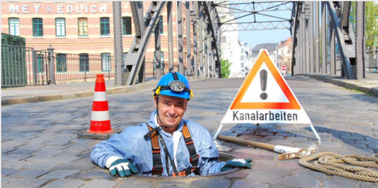
Bild 2: Inspektionen und Reparaturen sind wesentliche Elemente der Kanalbewirtschaftung. Der Abgleich geplanter mit durchgeführten Inspektionen ist regelmäßiger Bestandteil der Monatsberichte Kanalnetz
